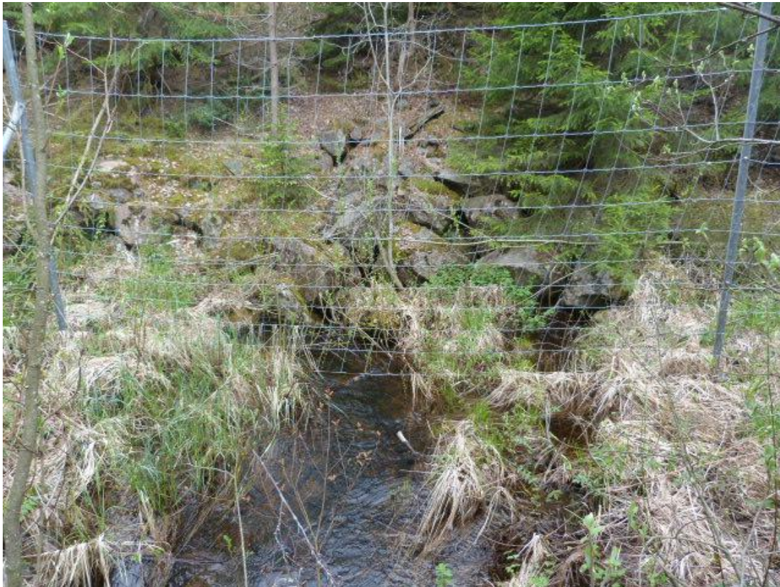
Bild nr 6: Läckage genom vägbanken under riksväg 50 ca 40 meter söder om vägtrummmorna. Bilden är tagen av Anders Bruks, VattenBruk's AB.
